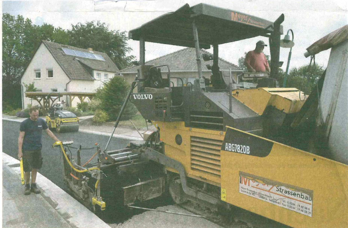
Mit dem Asphaltfertiger wird die Tragschicht auf der Kreisstraße 3 (Straße Am Dorfe) in Bornum aufgebracht.
