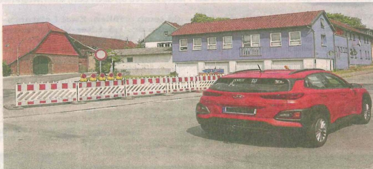
Die Kreisstraße 55 in Süpplingenburg ist seit einem Jahr gesperrt. Nun soll der Verkehr wieder fließen.
