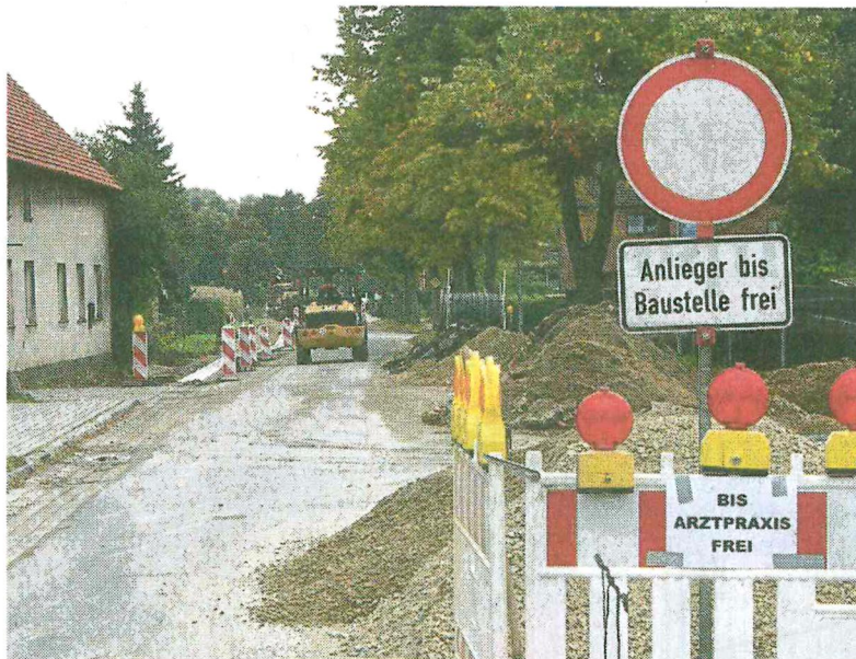
Die Ortsdurchfahrt in Meinkot wird mit schwerem Gerät erneuert. Foto: Erik Beyen
