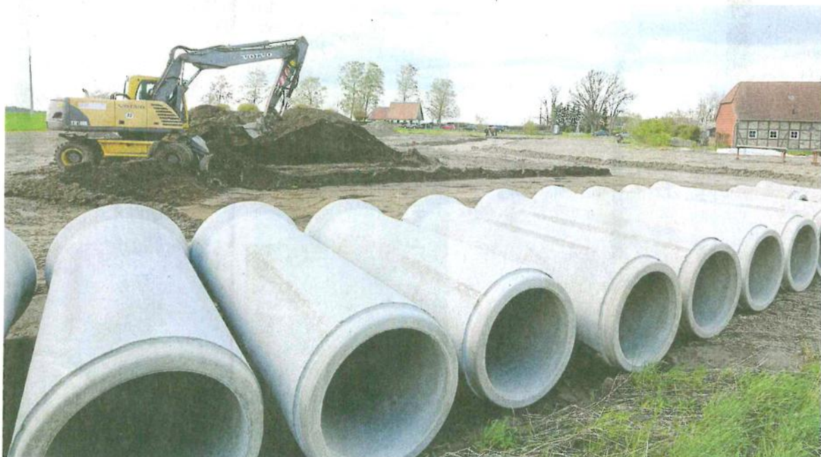
Im Baugebiet „Am Felde“ in Meinkot wird fleißig geschaufelt: In acht Wochen sollen die Grundstücke bebaubar sein.
