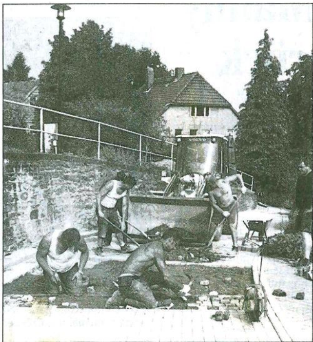
Thieberg: Die Pflasterarbeiten sind so gut wie abgeschlossen. Bis Mitte Juli soll die Straße fertig sein. Photowerk (amü)
