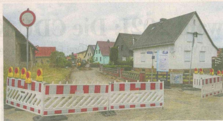
Ausbau und Erneuerung der Kanalisation des Birkenwegs in Warberg: Die Anwohner werden nicht mehr an den Kosten beteiligt
